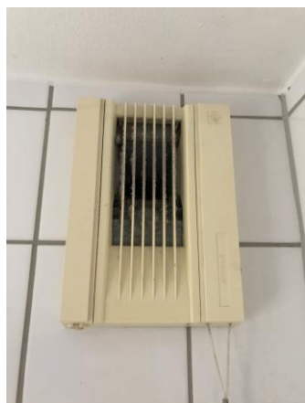
Frånluftsventil i badrum (Forceringsventil)
